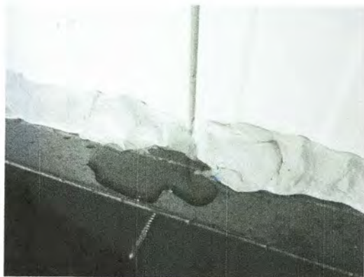
Bild 5 Wassereintritt beim Herauffahren auf 750 Pa an der linken, unteren Fuge
